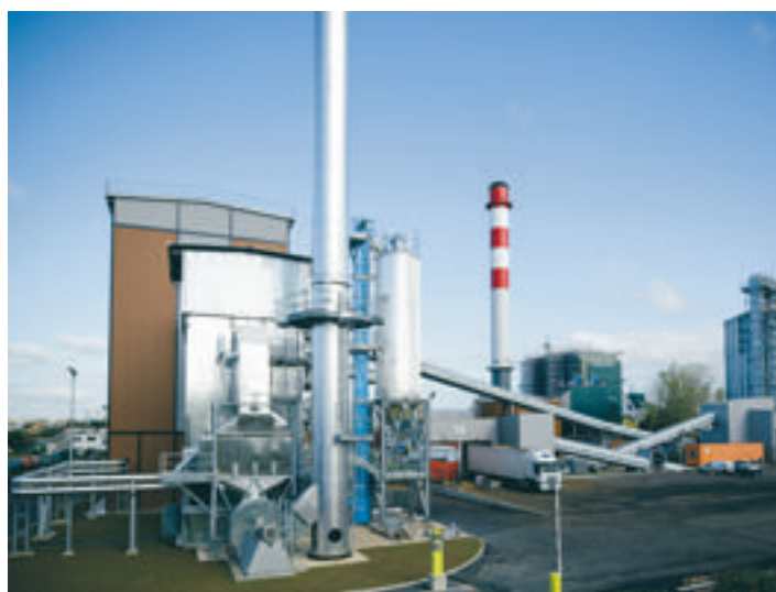
La plus grande chaufferie à bois de France a nécessité 17 millions d'euros d'investissement, un an et demi de travaux, et plusieurs mois de tests.
